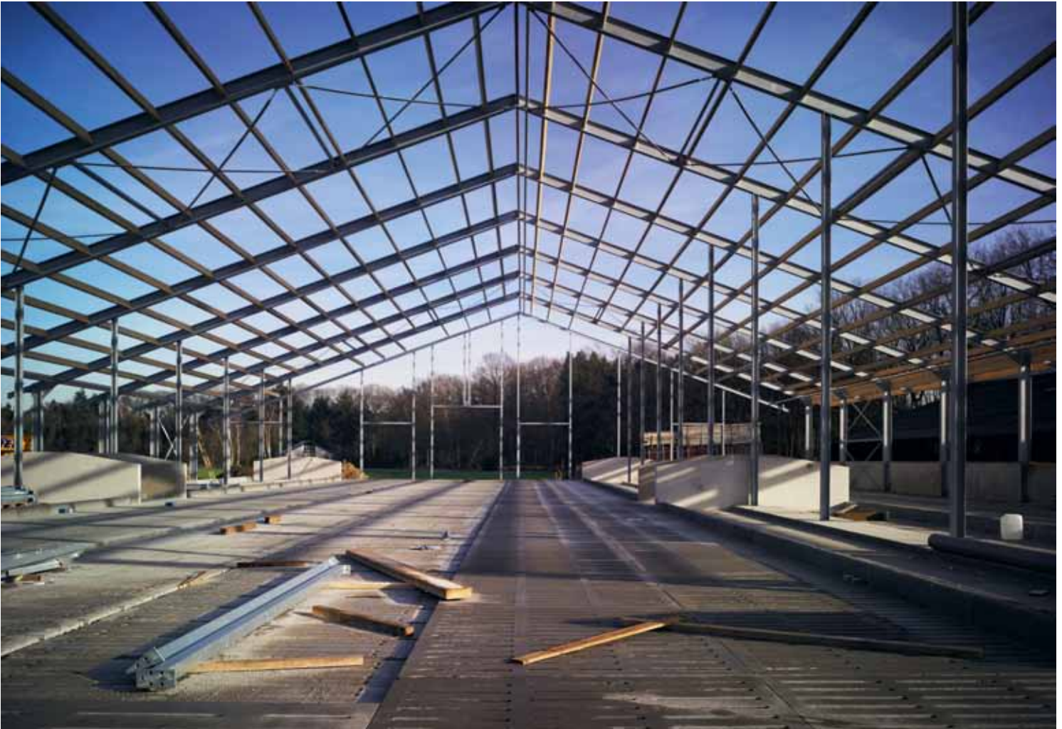
Bouw van een koeienstal waardoor de boer zijn veestapel kan uitbreiden en de pachtinkomsten kunnen stijgen.
